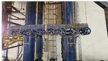
Controle de fluxo de elevadores | Fonte: GT
